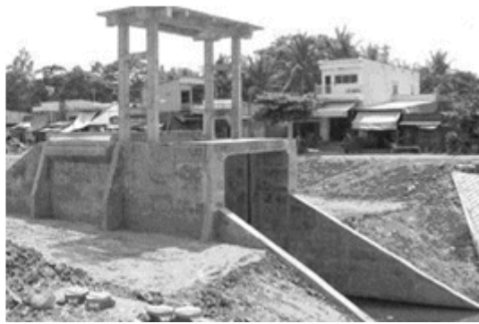
Công trình Bắc Vàm Nao (trái) và các cống kiểm soát nước (phải) (8)
